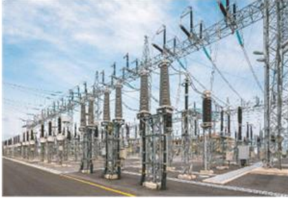
Trafo Merkezi Çelikleri
